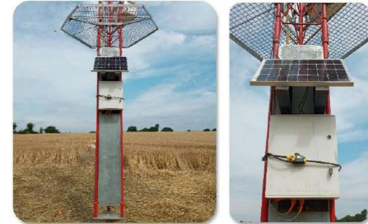
Photo 3 : Dispositif d'enregistrement sur le mât de mesure et environnement immédiat
